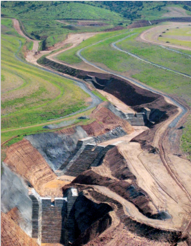
Las estructuras de caída de agua de Redrock Diversion se construyeron como parte del proyecto galardonado de recuperación en Tyrone, Nuevo México. Estas estructuras manejan el agua pluvial de una gran vertiente entre dos represas de relaves recicladas.
